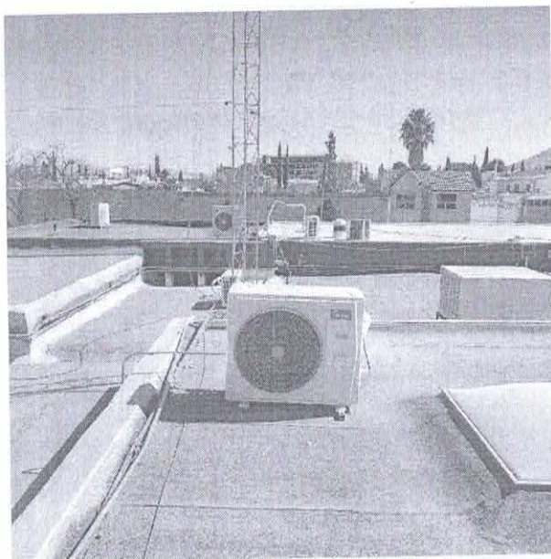
ENTRADA SALA ESPERA 3TON
