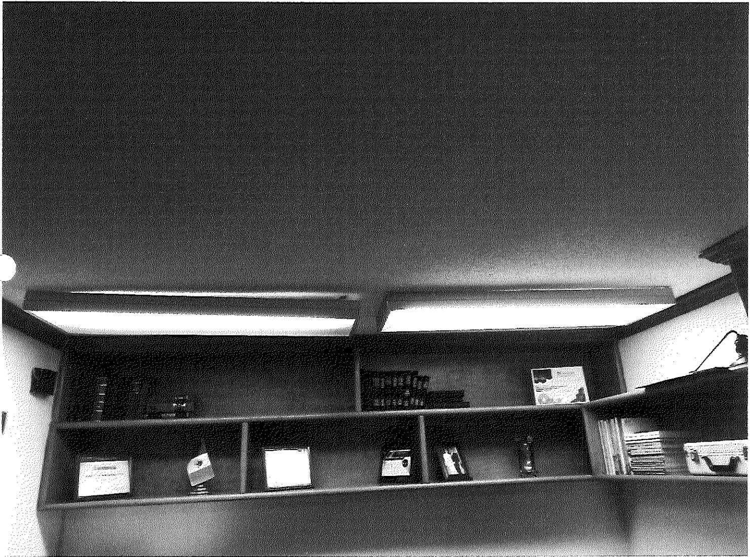
SOPORTE DE LAMPARA EN MAL ESTADO EN EL PRIVADO DEL LICENCIADO YAIR HERNANDEZ
