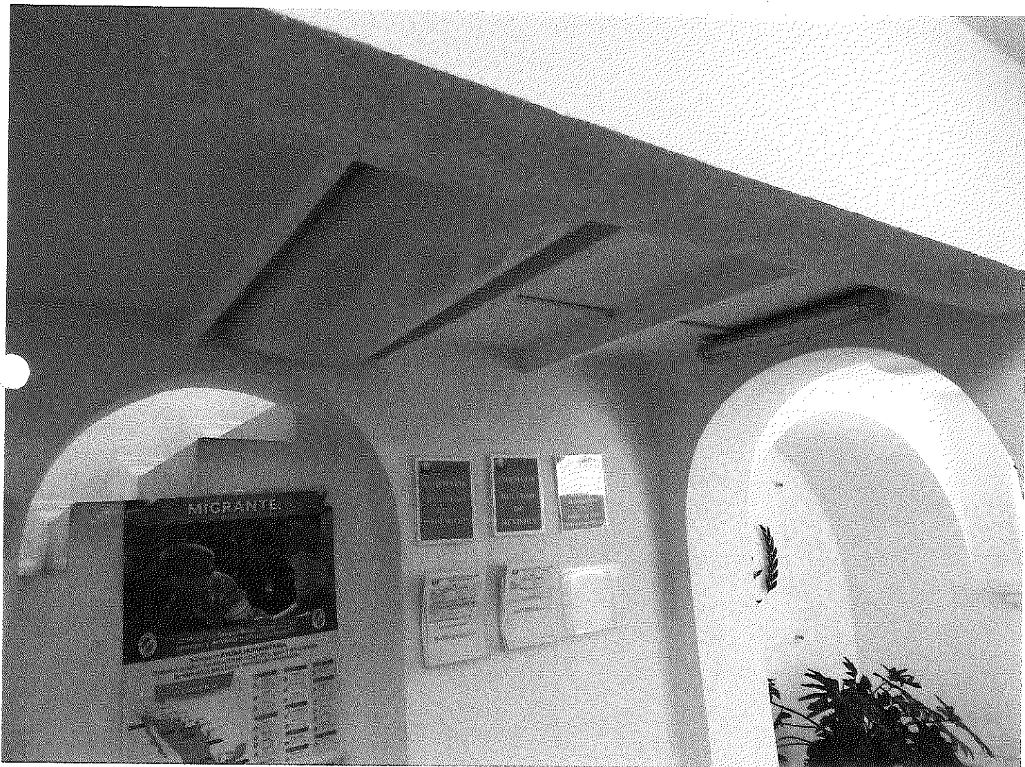
ENTRADA PASILLO PRINCIPAL LAMPARA SIN FUNCINAMIENTO Y LAMPARA DE EMERGENCIA NO FUNCIONA
