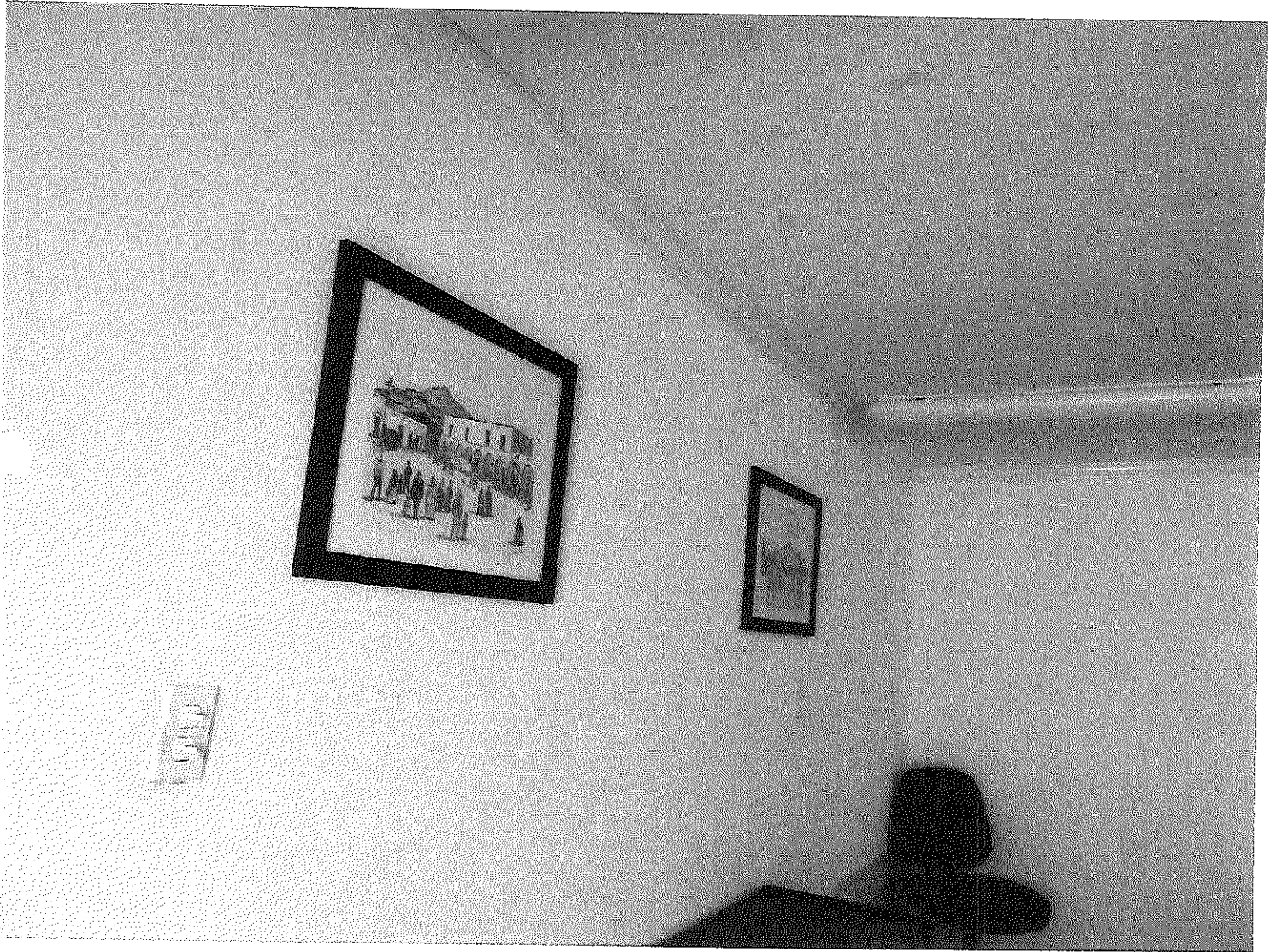
LAMPARA SIN FUNCINAR EN SALA DE JUNTAS
