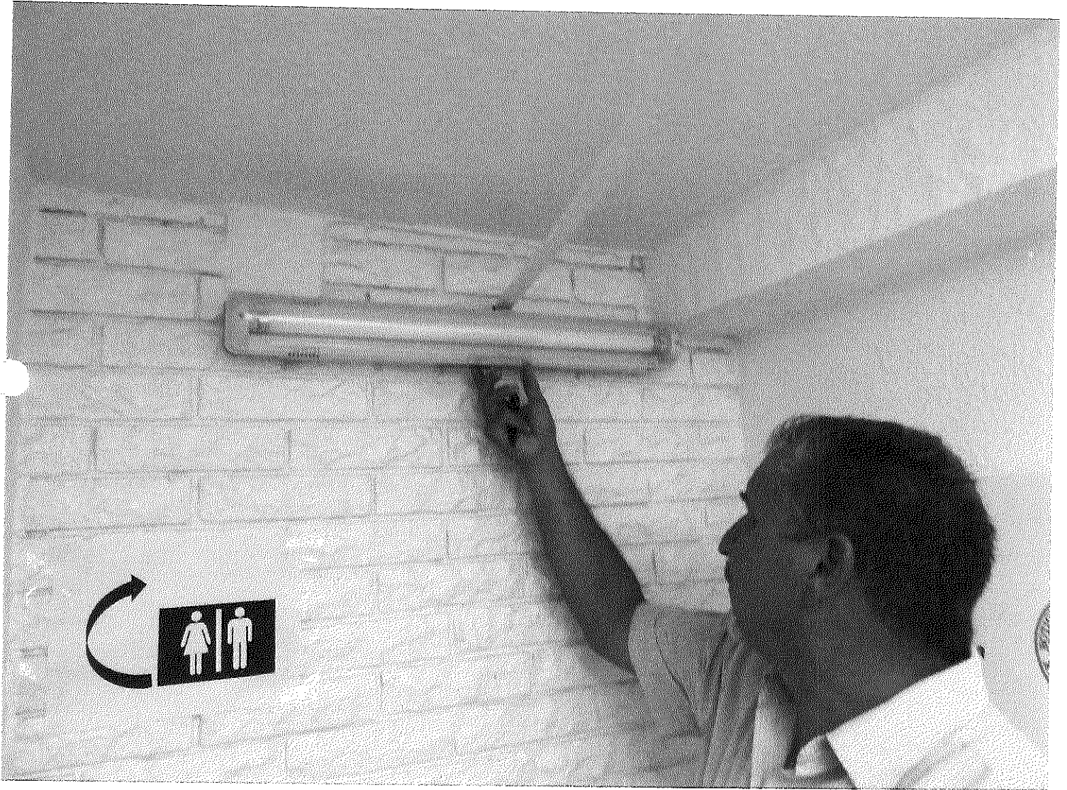
LAMPARA DE EMERGENCIA EN BUEN ESTADO
