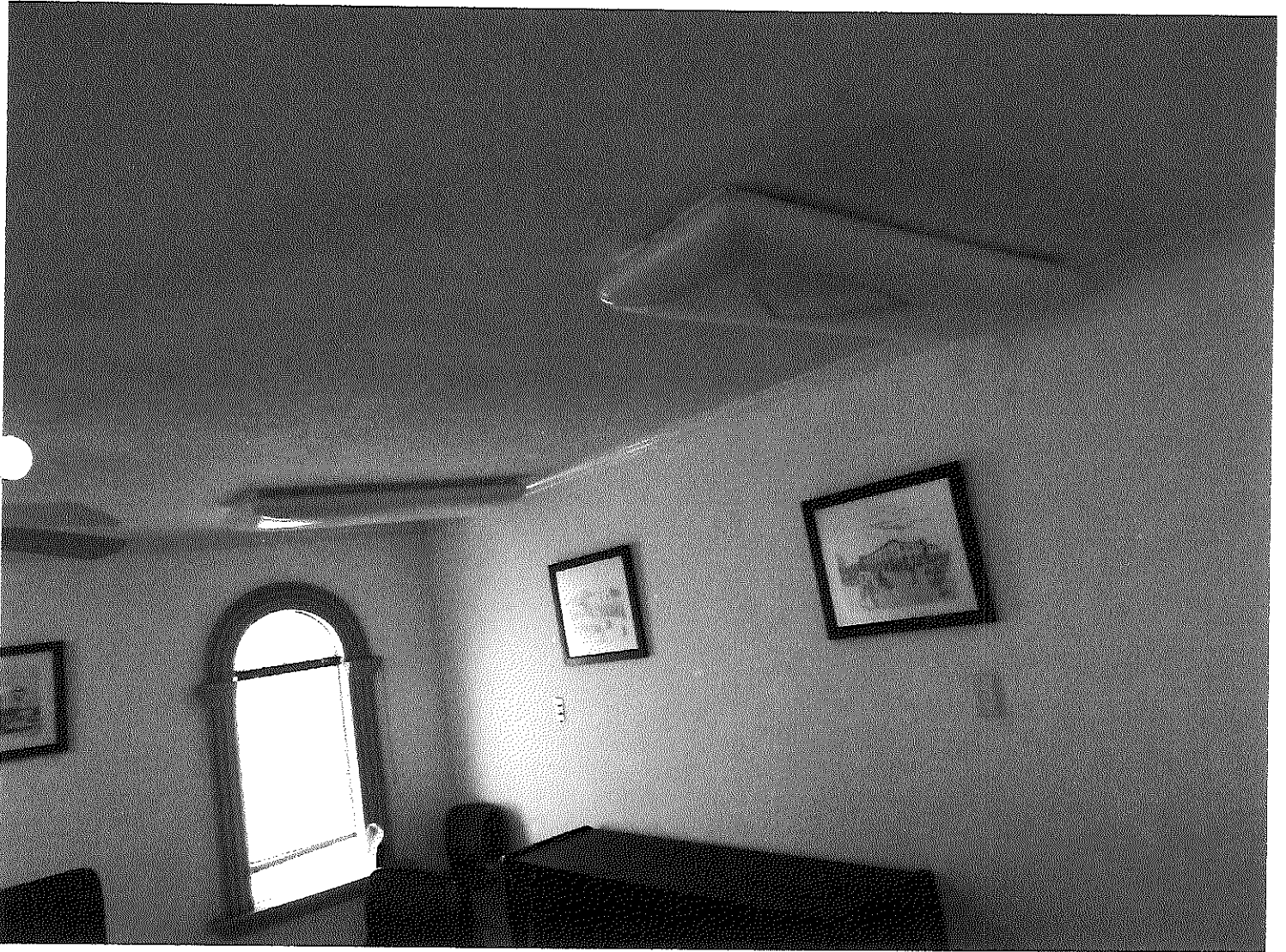
LAMPARAS DE LA SALA DE JUNTA SIN FUNCIONAR
