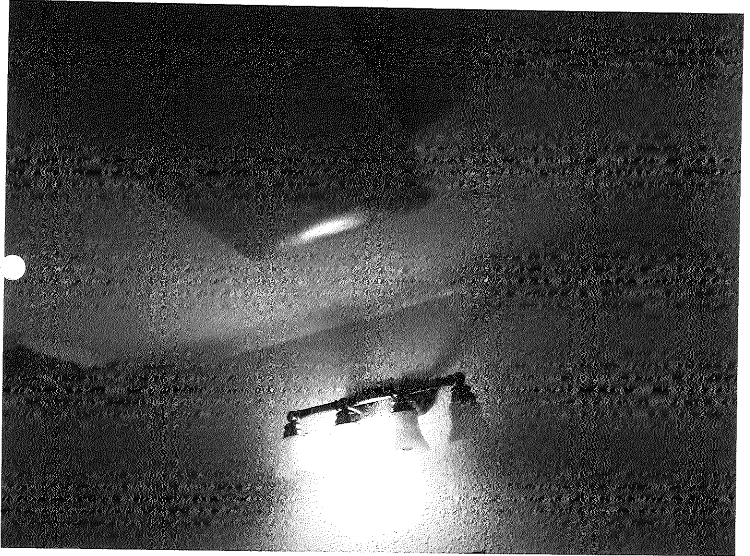
LAMPARA SIN FUNCIONAR EN BAÑO PLANTA BAJA
