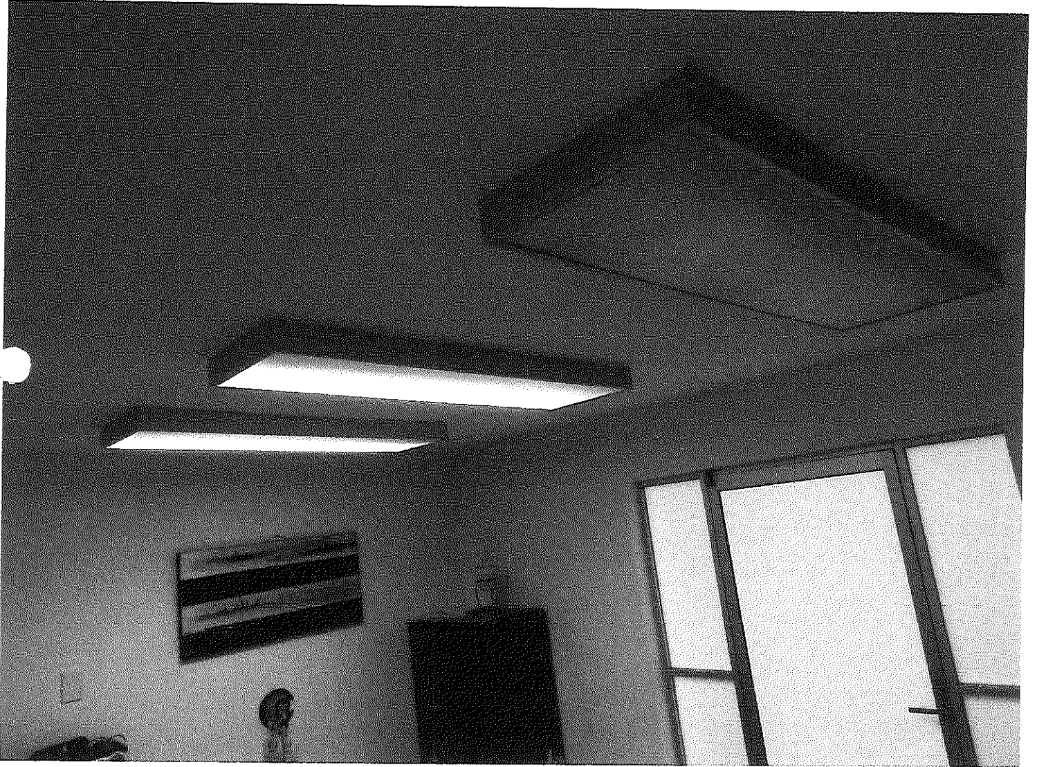
LAMPARA EN MAL ESTADO Y ACRILICOS EN MAL ESTADO DEL ESPACIO DE LA SECRETARIA TITULAR DE OFICINA
