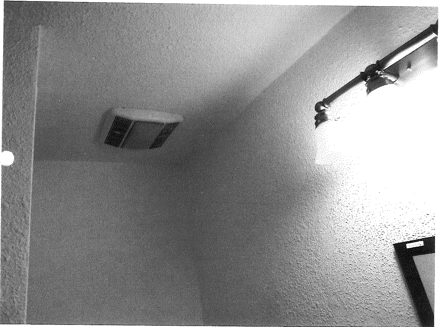
EXTRACTOR DE AIRE EN BAÑO DE PLANTA BAJA – NO EXTRAE LOS OLORES DE MANERA EFICIENTE
