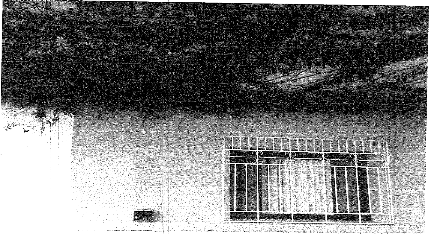
EVIDENCIA DE MURO DE LADRILLOS ANTERIOR A LA APLICACION DE ACRILICO.
